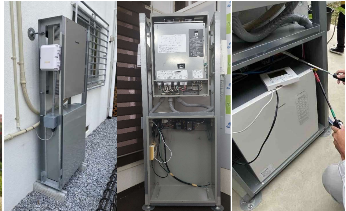
【 蓄電池筐体架台 】
