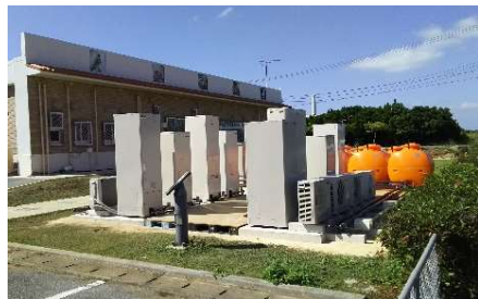
エコキュート・電気温水器 模擬負荷実証設備
